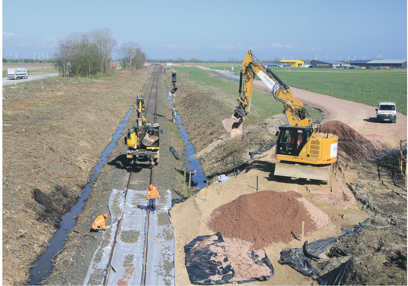
Im Bereich der Amalienhofer Brücke sind die von der Deutschen Bahn beauftragten Firmen zurzeit dabei, die Baustraßen fertigzustellen. FOTO: HÖPPNER
